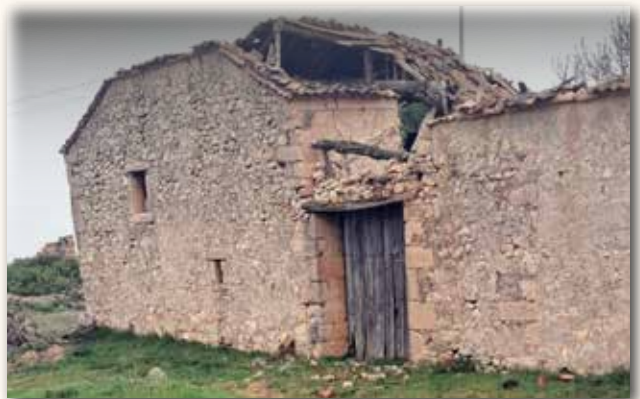
Estado actual de una vivienda de La Ventosilla
